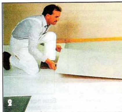
Гипсокартонные плиты чёрного пола укладывают в два слоя поверх плит изоляции и прочно склеивают друг с другом.
