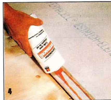
При укладке чёрного пола клей наносят на стенку фальца. Дополнительно плиты фиксируют шурупами.
